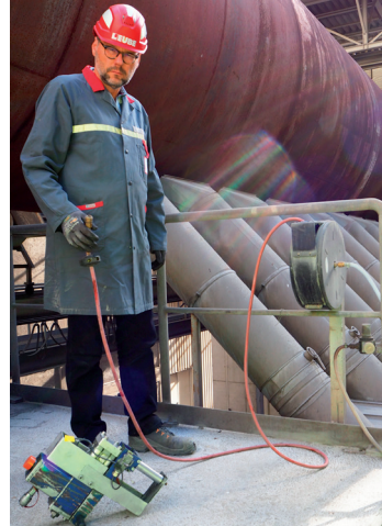
Sűrített levegő állomás a 2. forgógyűrűnél
