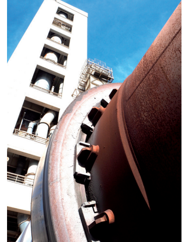
3-as forgókemence és hőcserélő torony a LEUBE Cementművénél
